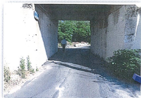
Pont nord Aménagement d'un cheminement sécurisé pour les piétons et les vélos
